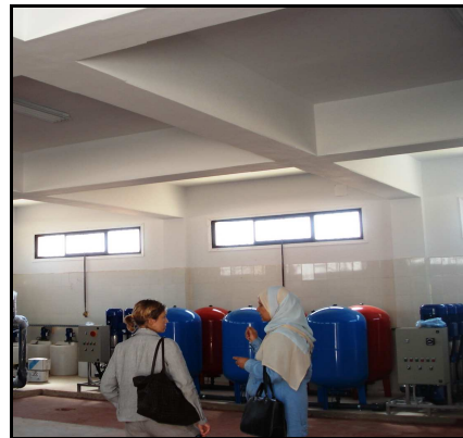
شكل (14) محطة تحليه الجفجافة
