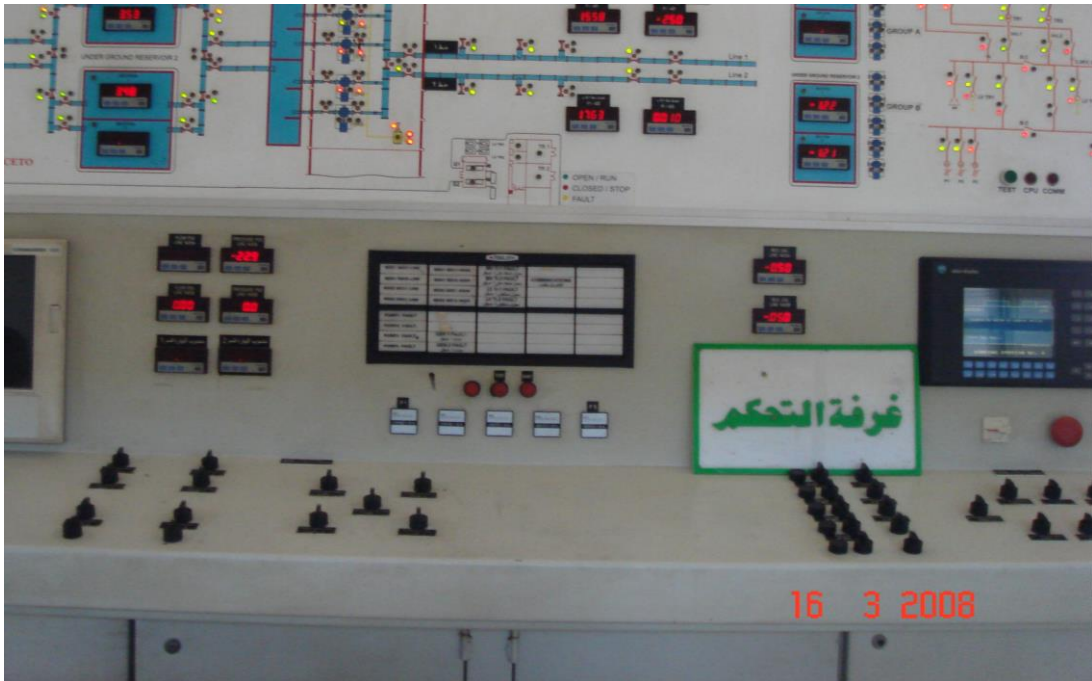
صورة ٢٨- غرفة التحكم لمحطة المياه المغذية لمدينة القاهرة الجديدة
