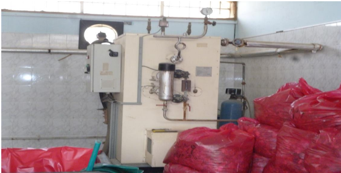
صورة ٣٩- وحدة المعالجة الحرارية
