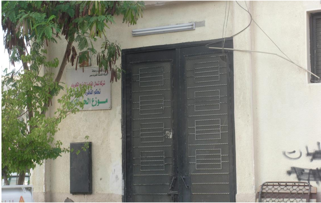
صورة ١٤- موزع كهرباء بالحي الرابع
