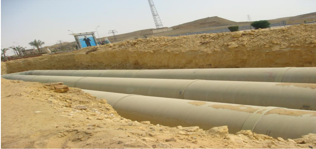
صورة -٢٩- مواسير نقل مياه الشرب
